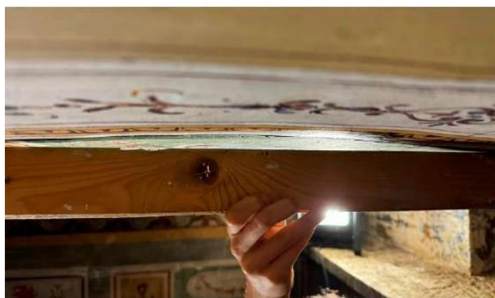
Fig. 65 Andamento irregolare del soffitto.
