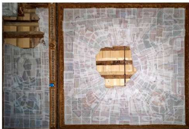
Fig. 100 Opera messa in sicurezza dagli opera (prima del restauro).
