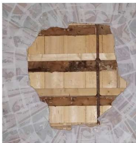
Fig. 52 Fotografia della lacuna centrale (prima del restauro)
