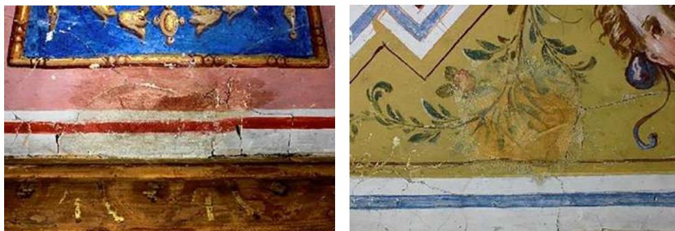
Fig. 116-117 Stuccature eseguite in interventi pregressi, posizionate lungo il perimetro della decorazioni centrale del soffitto.
