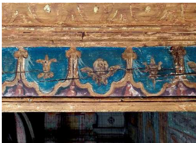
Fig. 114 Fratture del legno delle travi ricalcate.
